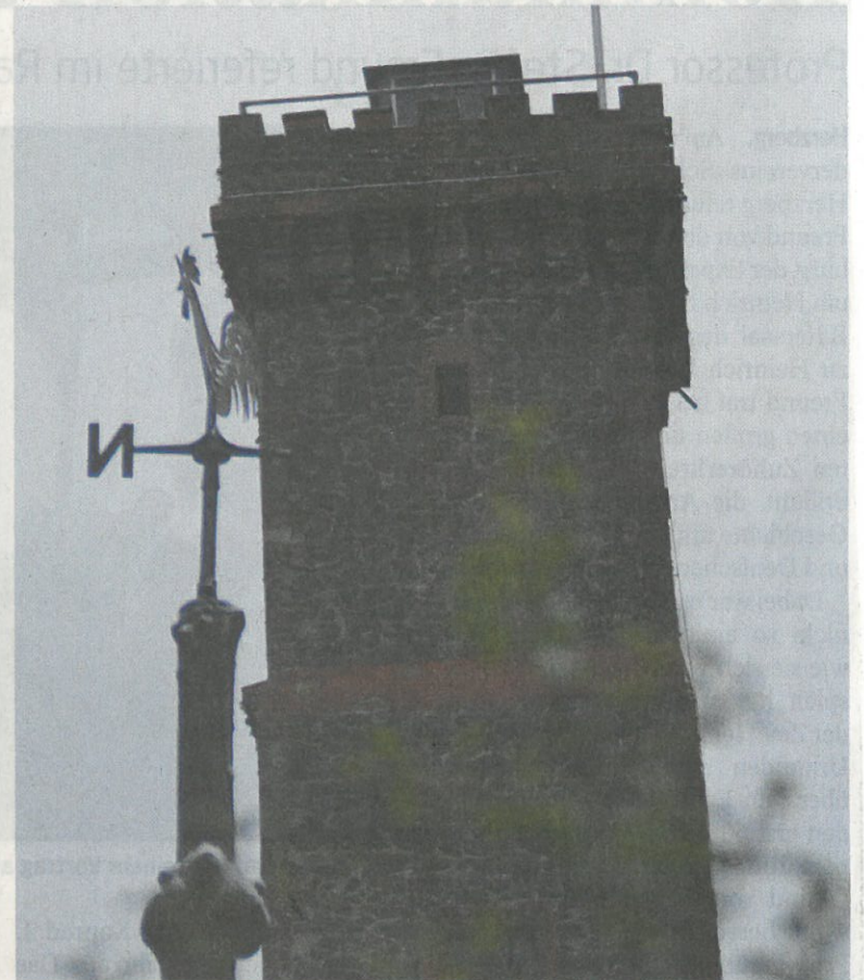
Der Bismarckturm auf dem Kummel in Bad Lauterberg muss dringend renoviert werden.
