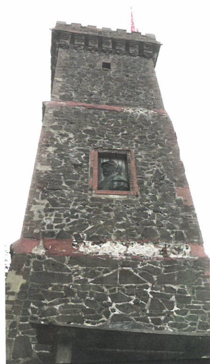
Die Schäden an der Substanz des denkmalschutzten Turms sind deutlich zu sehen. Foto: © Sabine Kilzer
