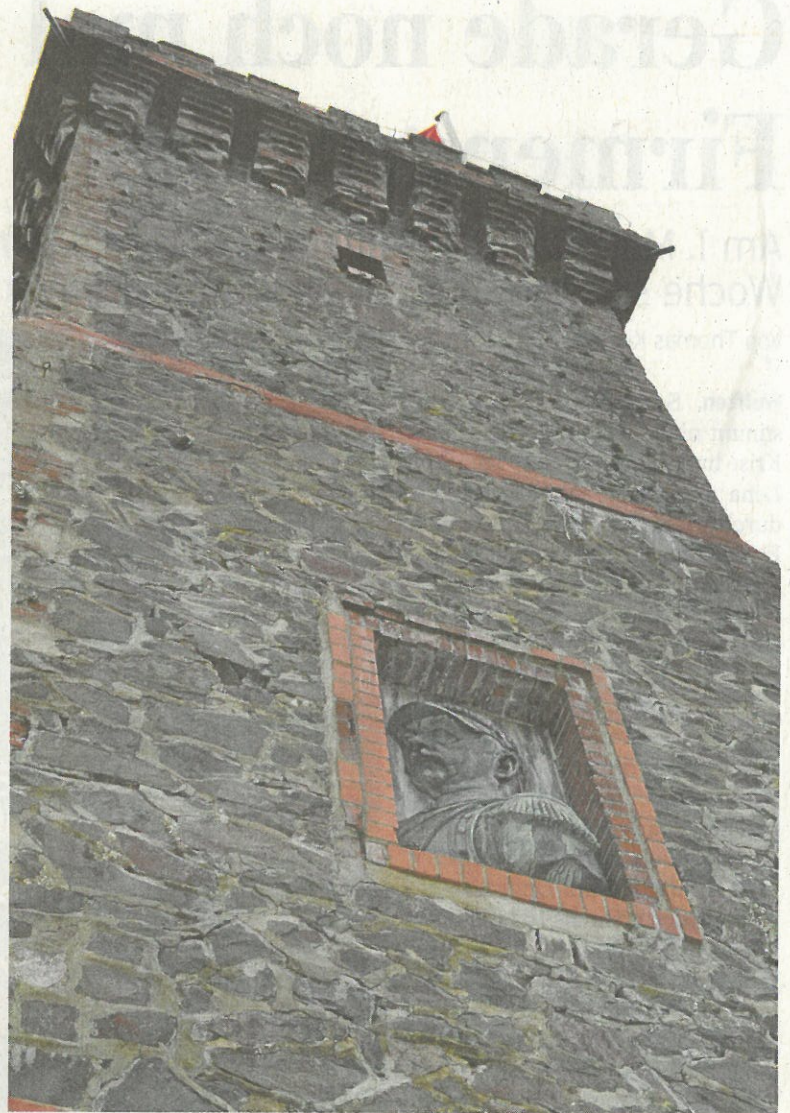
Der Bismarckturm ist ein Wahrzeichen für Bad Lauterberg. Er muss saniert werden.
